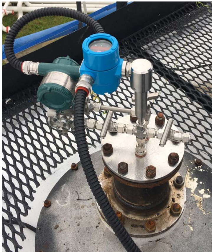
Рисунок 15 – Размещение уровнемера ВЕКТОР-ДПТ на резервуаре
