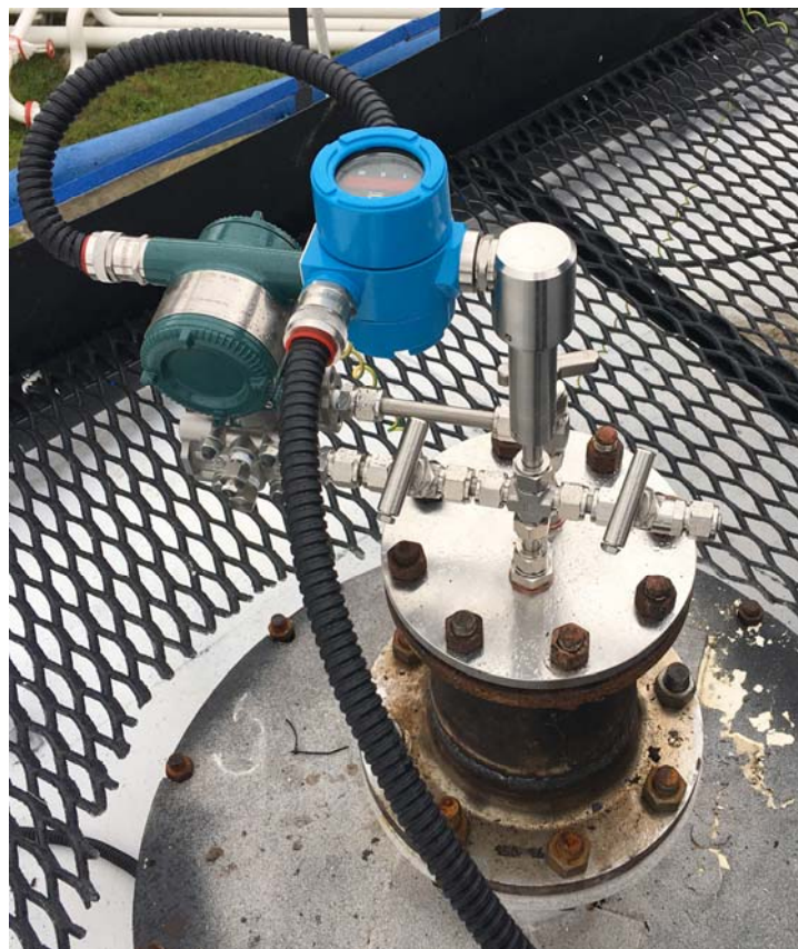
Рисунок 16 – Размещение уровнемера ВЕКТОР-ДПТ (плотномера) на резервуаре
